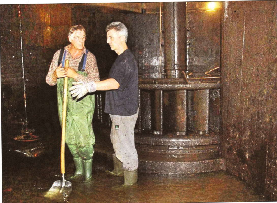
Hier steht das Wasser sonst drei Meter hoch: Lutz Lorenz und Wolfgang Reimann im Inneren des Wasserkraftwerks neben einer der beiden Turbinen. Fotos: Meyer
